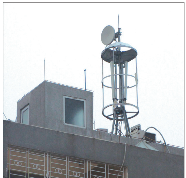
Trạm BTS không công kênh của Viettel Thanh Hóa.
